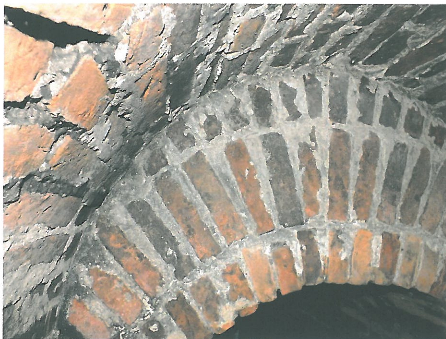
Fot. 9. Brak zarysowań na sklepieniu korytarza C oraz zamykającego łuku.
