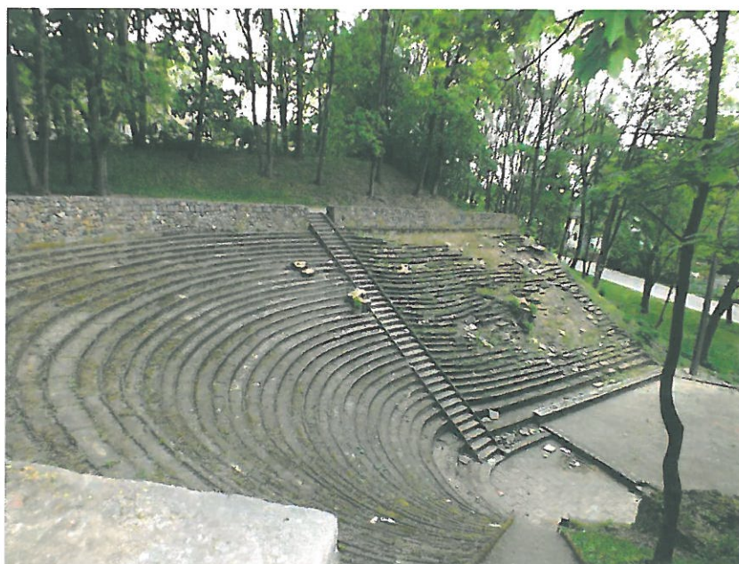
Fot. 16. Przykład destrukcji wzgórza i jego zabudowy poprzez działanie roślinności w istniejącym podłożu gruntowym.
