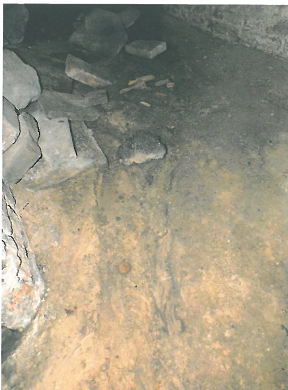
Fot. 15. Ślady po kierunku ściekania wody i nanoszenia gruntu (korytarz B)
